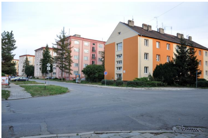
Špatný technický stav povrchu komunikace v křižovatce, umístění kruhového objezdu, špatný technický stav chodníků
