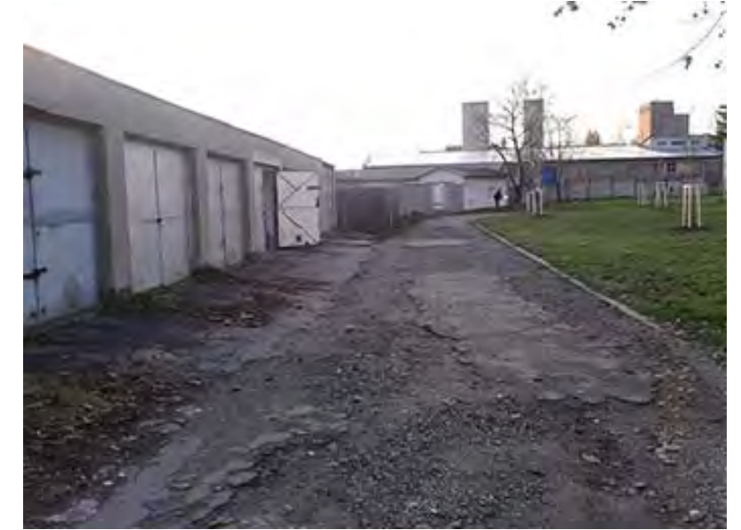
Obslužná komunikace v západní části sídliště s rozpadlým povrchem.
