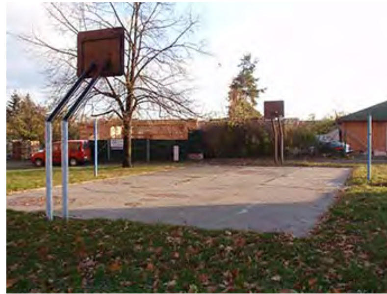
Hřiště pro míčové hry u domu č. 13. Popraskaný povrch, neoplocené a blízko cesty.
